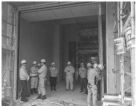
開口部の防水シャッター
