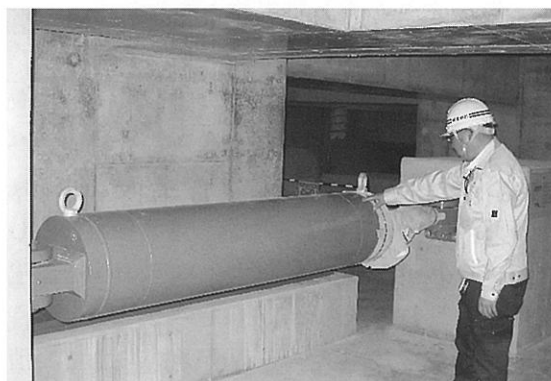
地下部の免震装置
