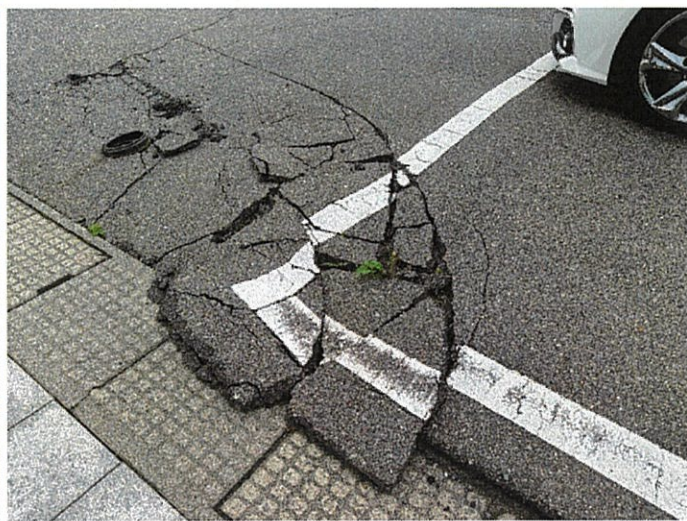
アスファルト破損状況
