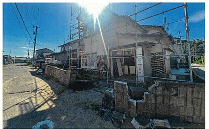
震災後 液状化現象により全体が沈下
