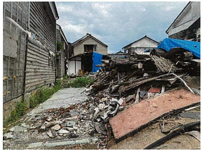
朝市通り崩壊建物
