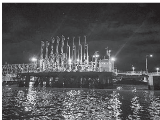
震度9まで想定された船着き場のオイルパイプ群
